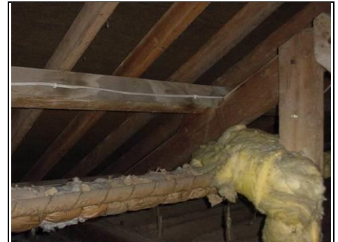
Lagging - possible asbestos
